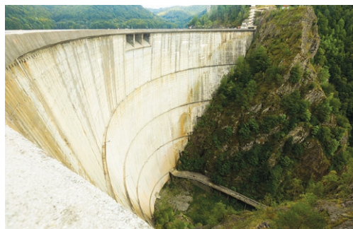
Fig. 1. Hidrocentrala Vidraru – barajul
